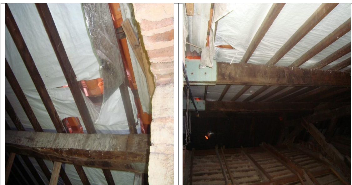
Rompimento da manta de alumínio instalada na subcobertura da Catedral Metropolitana. Aracaju/SE, 26.09.2019.
