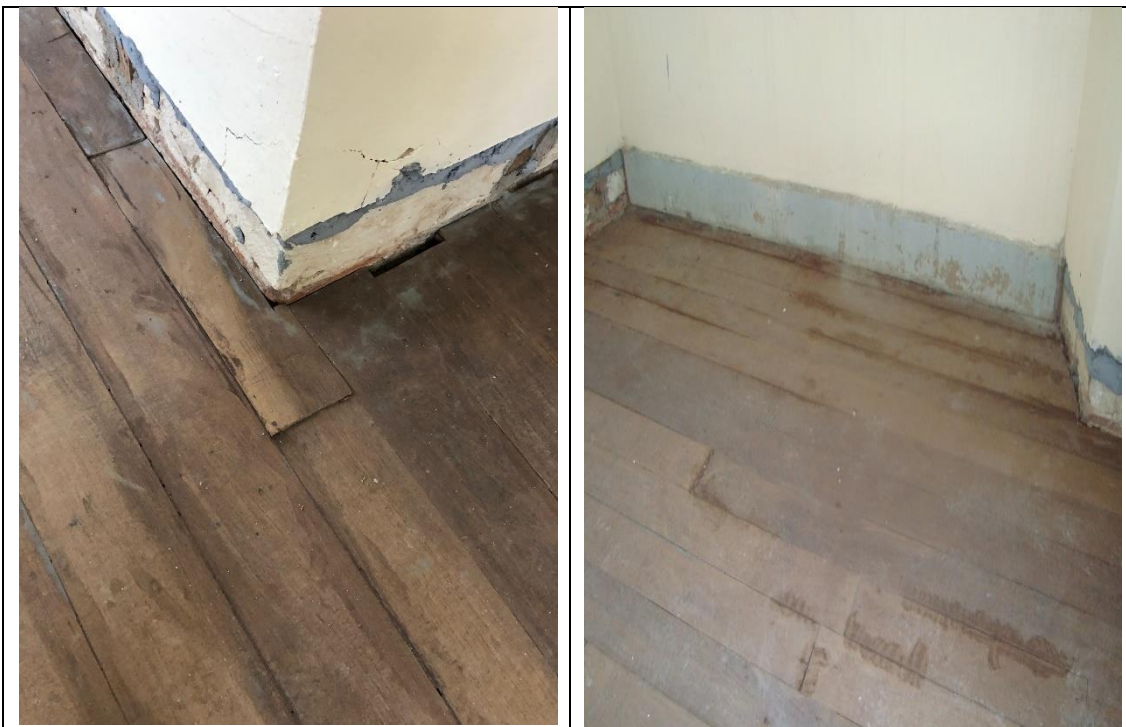
Presença de manchas de umidade no assoalho do pavimento superior da Catedral Metropolitana. Aracaju/SE, 26.09.2019.
