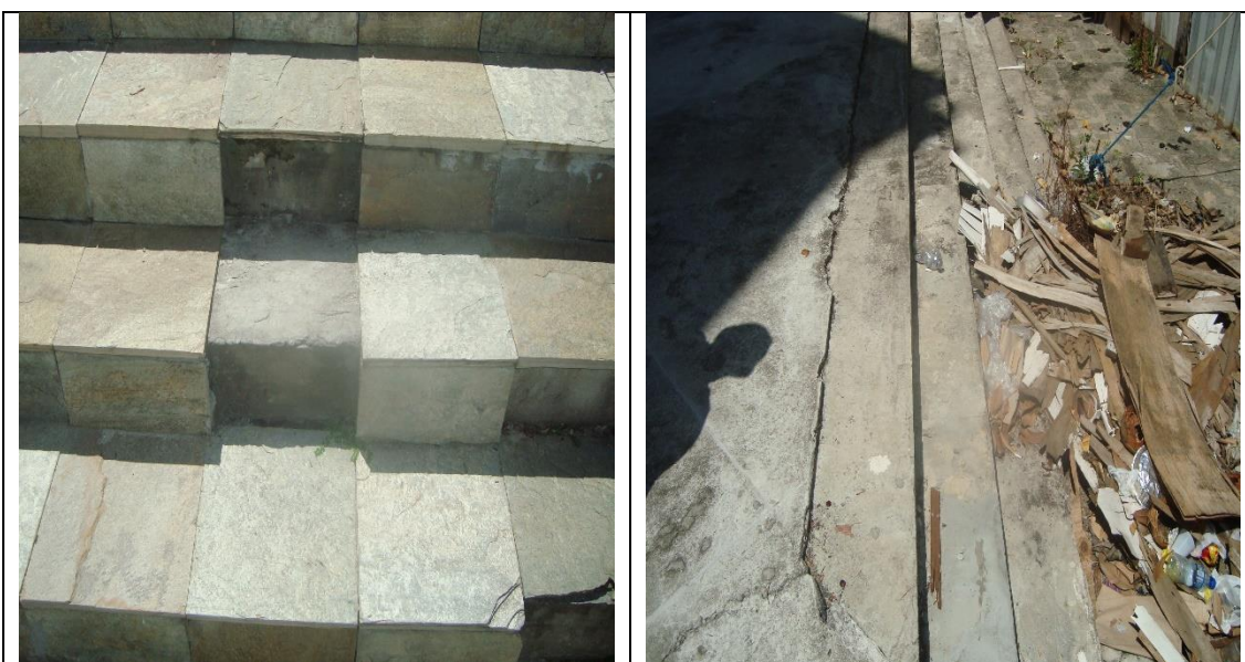
Placas de piso em pedra lagoa santa faltando na escadaria ao fundo da Catedral. Aracaju/SE, 26.09.2019.
