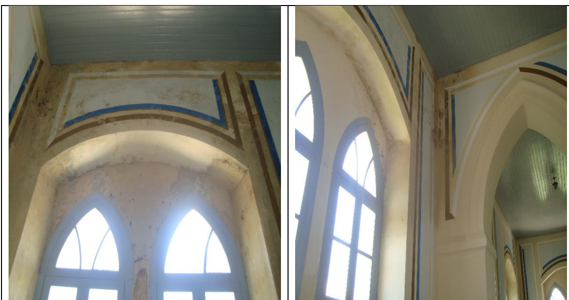
Infiltrações nas paredes laterais do pavimento superior da Catedral Metropolitana. Aracaju/SE, 26.09.2019.
